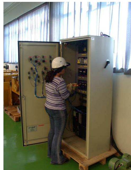
Recherche de panne dans une armoire électrique
